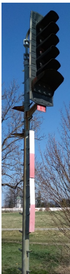
Obrázek 6: Světelné návěstidlo – Žst. Č. Budějovice (autor: Jan Bárta)
