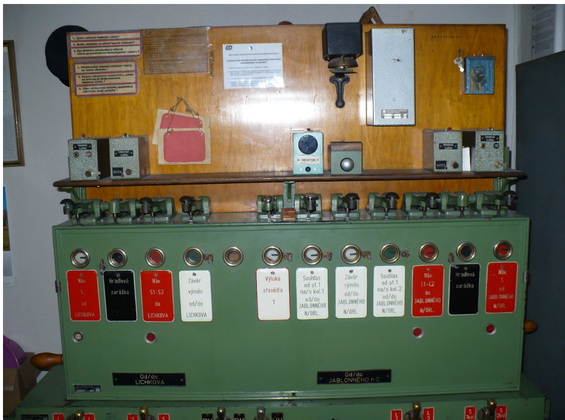
Obrázek 10: Elektromechanická skříň – Žst. Těchonín (autor: Jan Bárta)
