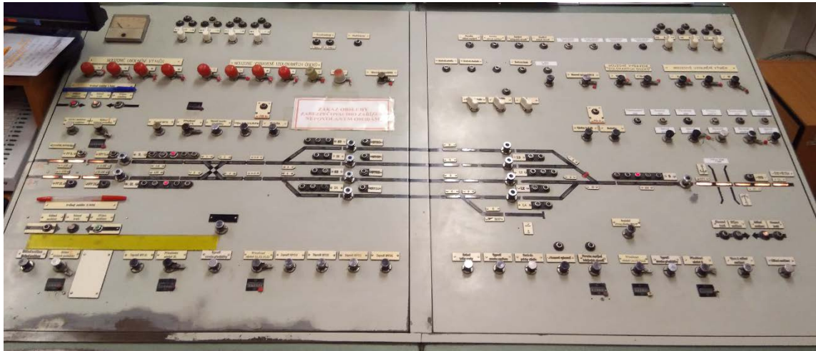
Obrázek 14: Kolejová deska s tlačítkovou volbou- Žst. Chotýčany (autor: Denis Hrbek)
