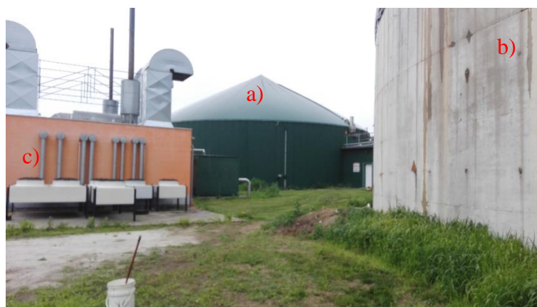
Obrázek 10 bioplynové stanice zemědělského družstva Sever Loukovec (středisko Chocnějovice) a) jedna z fermentačních nádrží, b) skladovací jímka, c) kogenerační jednotka
