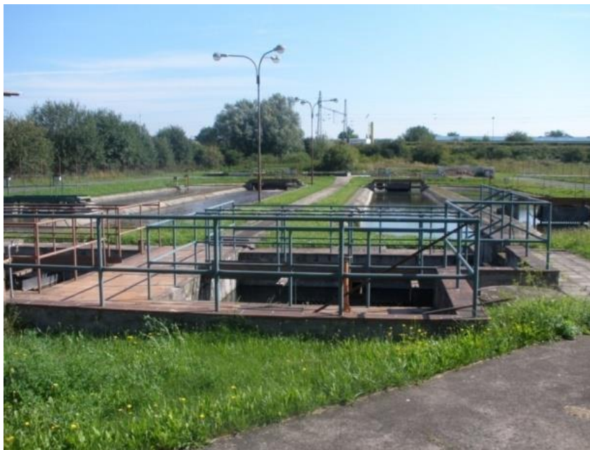
Obr. 11 ČOV Čebín - Biologická část [11]
