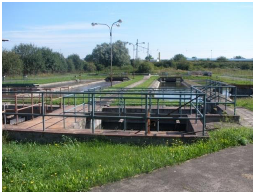
Obr. 11 ČOV Čebín - Biologická část [11]
