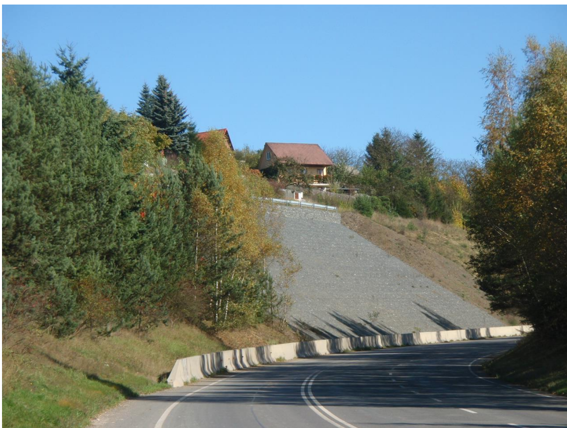
Příloha 33.: Nově zajištěný sesuv u Nového Strašecí. (Zdroj: Lubomír Šíma)
