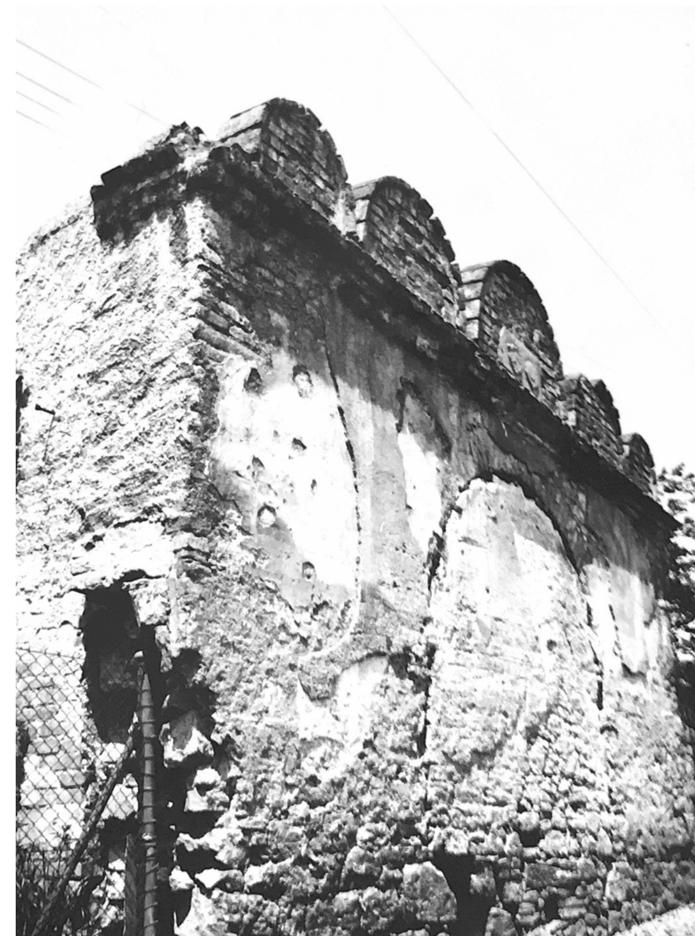
Obr. 20 - Dnes již zaniklá renesanční brána v roce 1976 (převzato z: SÚRP MO. Nelahozeves - zámek: stavebně historický průzkum.1976.)
