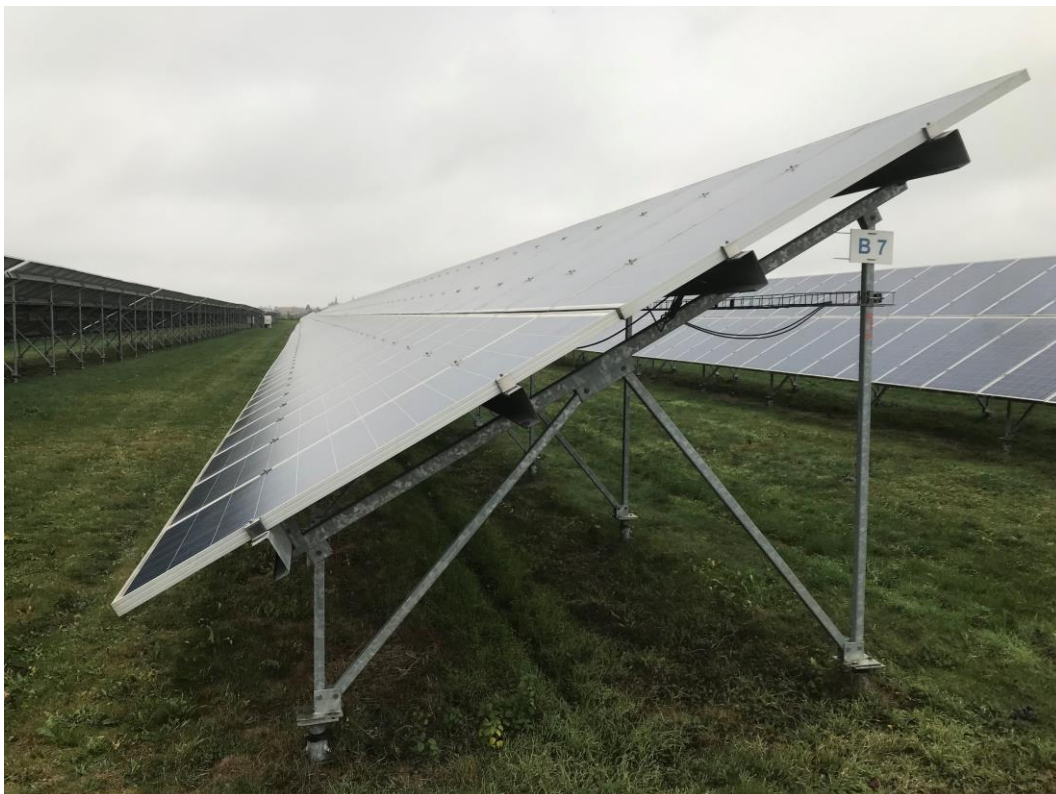
obr. 2-3 Dva solárne moduly na hliníkovej konštrukcii – FVE Brno-Tuřany
