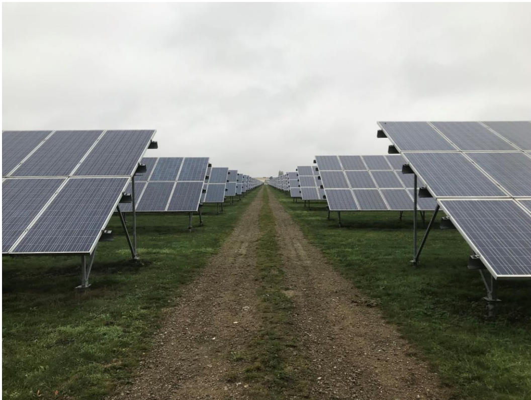
obr. 2-2 Rozostupy medzi stĺpcami – FVE Brno-Tuřany
