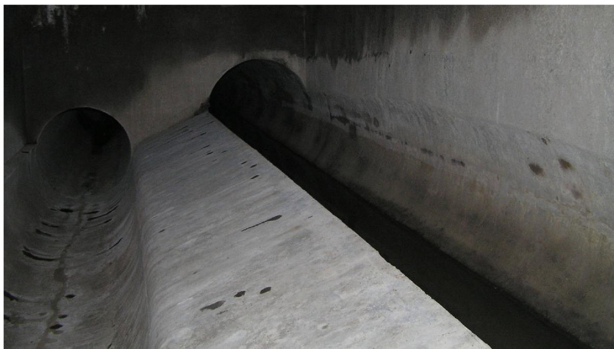
Obr. 2.5 Odlehčovací komora s jednostranným bočním přepadem – OK A6 v Brně
