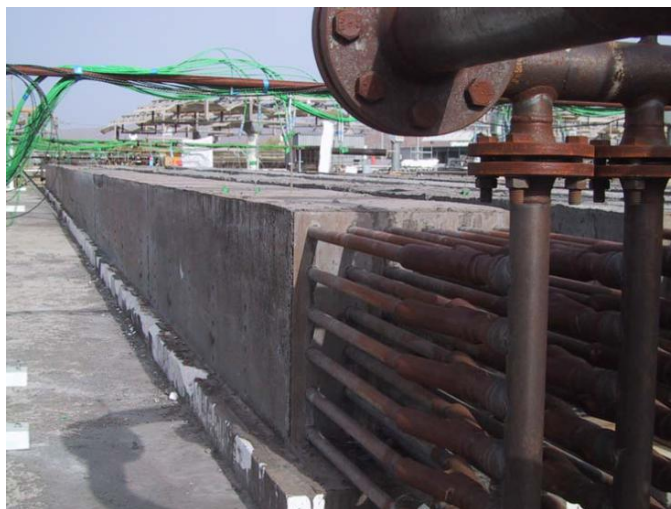
Obr. 74 Fotografie tepelného úložiště z betonu u sluneční elektrárny Plataforma Solar de Almería (Laing et al. 2006)
