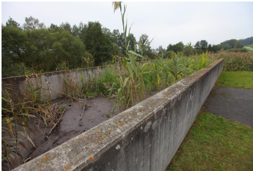
Obr. 22 Kalové pole v betonovém objektu (Rakousko, ČOV pro 120 EO, zdroj: Křiška)
