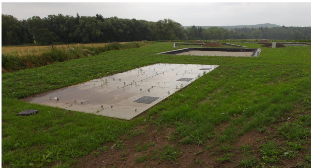
Obr. 14 Velkoobjemový tříkomorový septik jako monolitická ŽB nádrž realizovaná na místě (obec Skašov)
