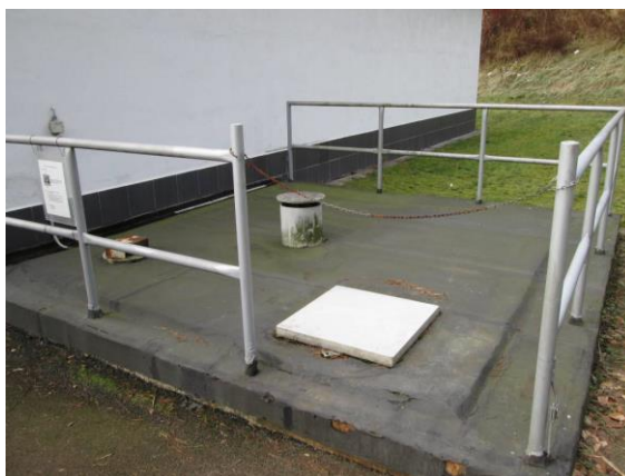
Obr. 5.5.5. Pohled na akumulační nádrž [10]
