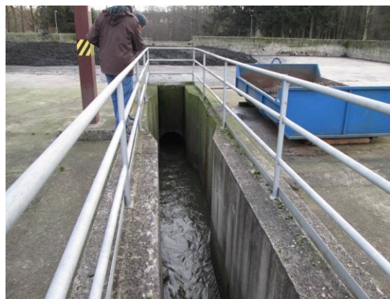
Obr. 5.5.1.2. Pohled na přítok do lapáku štěrku, pohled na rozšíření v místě sedimentace štěrku, vpravo kontejner na štěrk [10]
