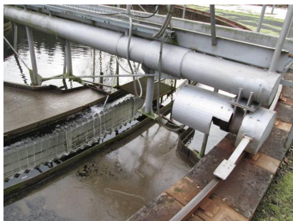
Obr. 5.5.2.11. Pohled na shrabovač a čistící zařízení [10]
