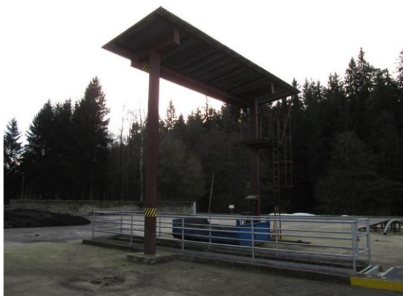
Obr. 5.5.1.1. Celkový pohled na lapák štěrku, ŽB žlab štěrku, částečně zastřešená konstrukce vybírače s drapákem štěrku a přistavený kontejner na štěrk [10]
