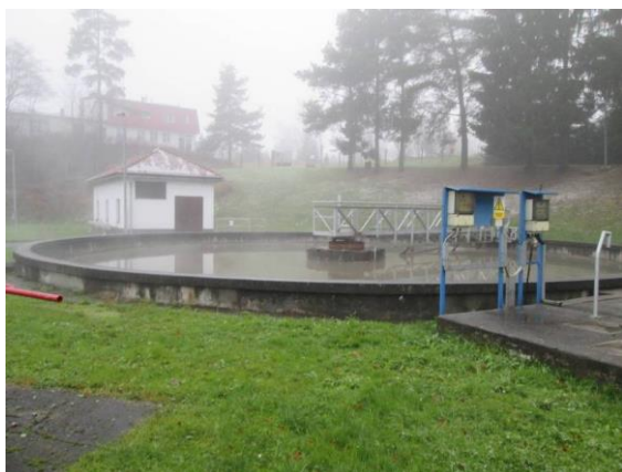
Obr. 5.5.1.3. Pohled na usazovací nádrž s točivou mostovou konstrukcí se stíráním hladiny, v pozadí budova nové dmychárny [10]
