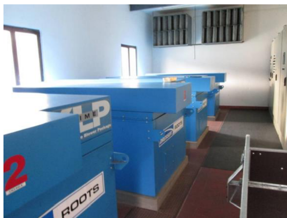
Obr. 5.5.2.5. Pohled na dmychadla ve vnitřních prostorách objektu nové dmýchárny [10]
