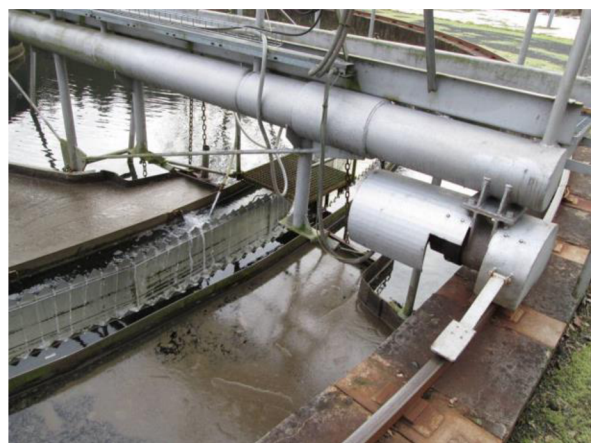
Obr. 5.5.2.11. Pohled na shrabovač a čistící zařízení [10]
