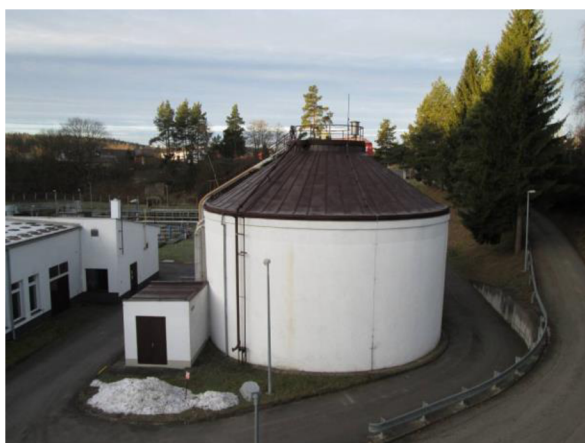
Obr. 5.5.3. Pohled na vyhňivací nádrž vpravo a čerpací stanici vyhnílého kalu vlevo [10]
