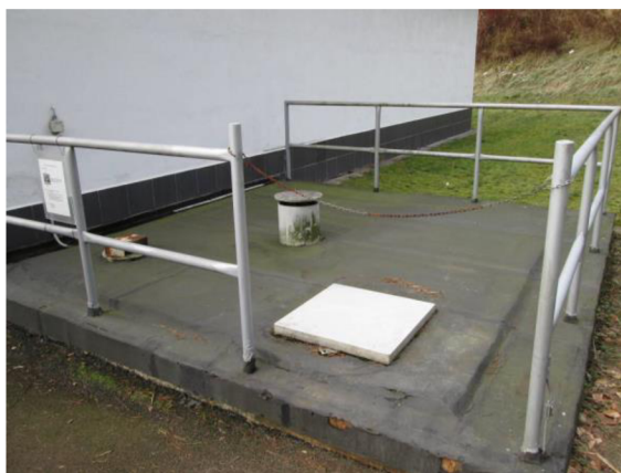
Obr. 5.5.5. Pohled na akumulační nádrž [10]
