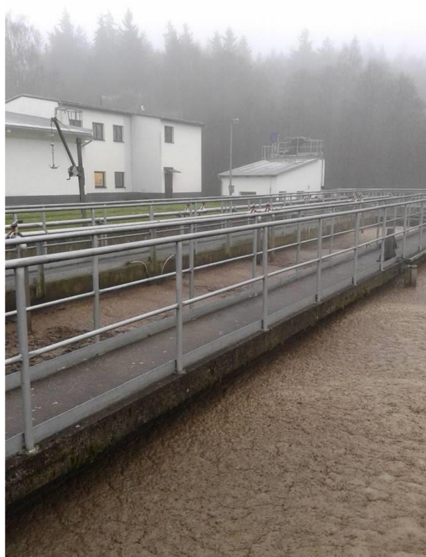
Obr. 5.5.2.2. Pohled na přítokové potrubí do původní AN, v popředí pohledové betony původní AN [10]
