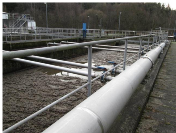
Obr. 5.5.2.4. Pohled na novou aktivační nádrž a přívodní potrubí vzduchu do AN [10]
