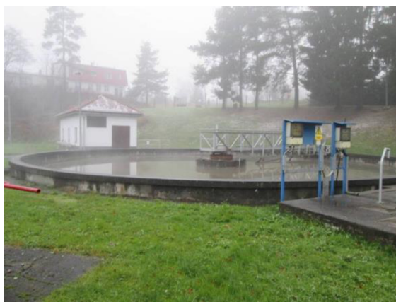
Obr. 5.5.1.3. Pohled na usazovací nádrž s točivou mostovou konstrukcí se stíráním hladiny, v pozadí budova nové dmychárny [10]
