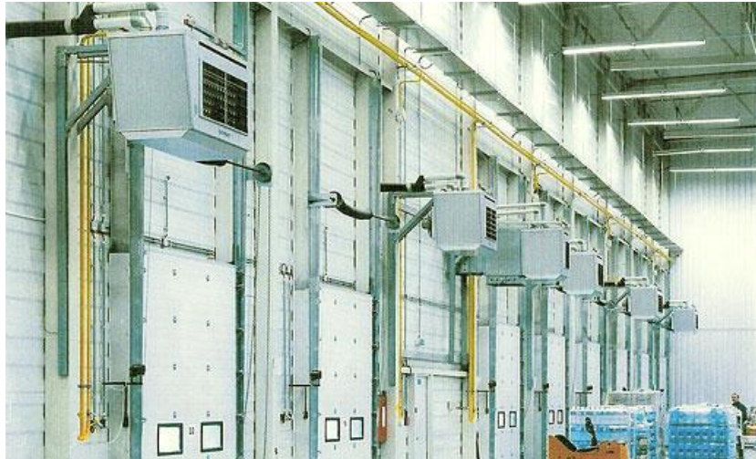
Obrázek 2.9: Vytápění haly teplovzdušnými jednotkami.
