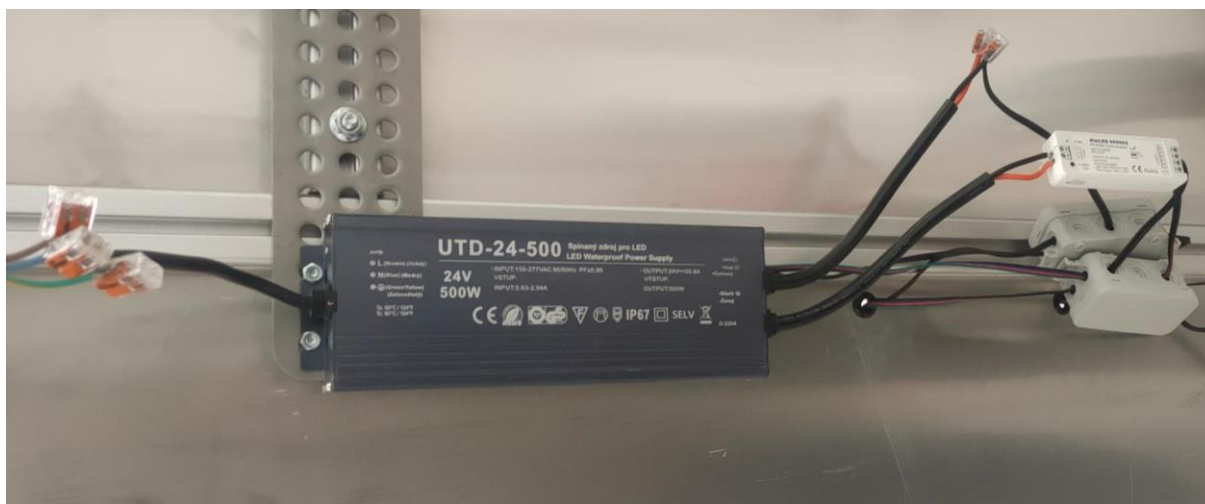
Obr. 24 Elektroinstalace LED osvětlení Přípojení na síť (vlevo), zdroj (uprostřed), rozvodové krabičky a řídicí elektronika (vpravo)
