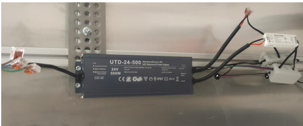
Obr. 24 Elektroinstalace LED osvětlení Přípojení na síť (vlevo), zdroj (uprostřed), rozvodové krabičky a řídicí elektronika (vpravo)
