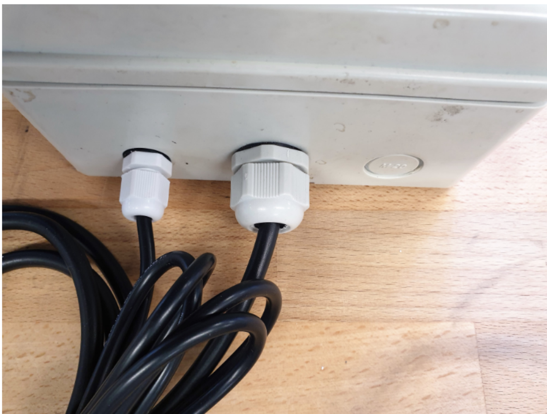
Obrázek A.28: Vstupy do rozvodnice přes průchodky IP66, vlevo vodič převodníku USB/RS-485 a vpravo síťový vodič
