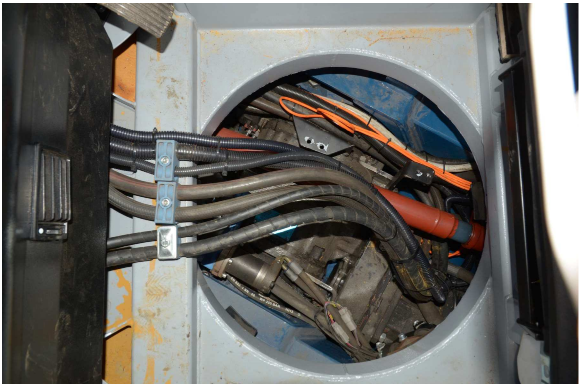
Obr. 135 Pohled na umístění kardanu v prostoru pod rotující kabinou
