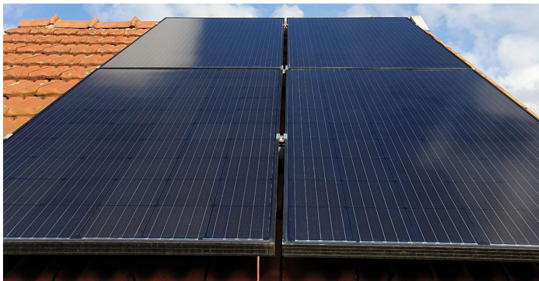
Obrázek 18 – Instalované solární panely (Zdroj: vlastní)
