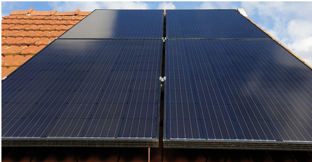
Obrázek 18 – Instalované solární panely (Zdroj: vlastní)
