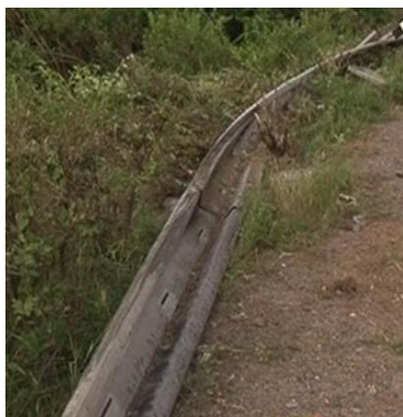
Obrázek 4 - pohled na dřecí stopu na svodidle
