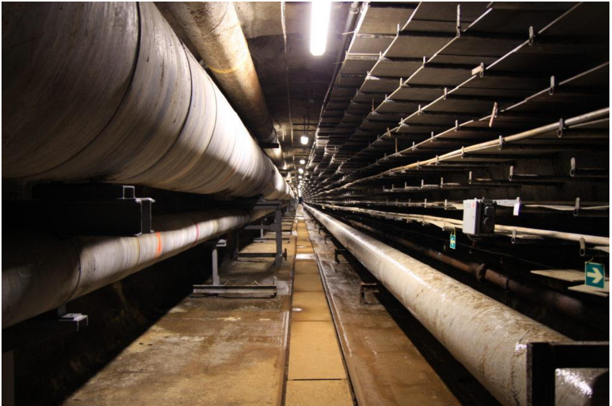
Obrázek 14: Fotografie kolektoru v Brně [21]
