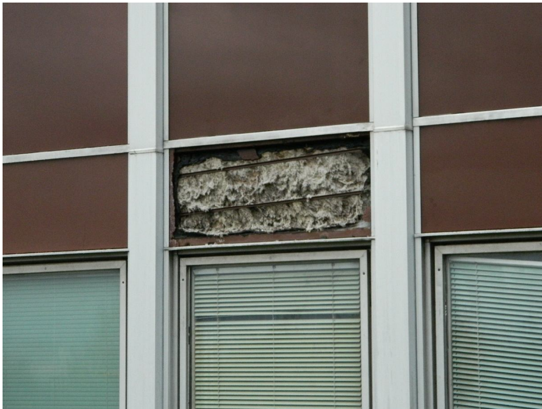
Obr. 31 Pohled na degradovanou tepelnou izolaci
