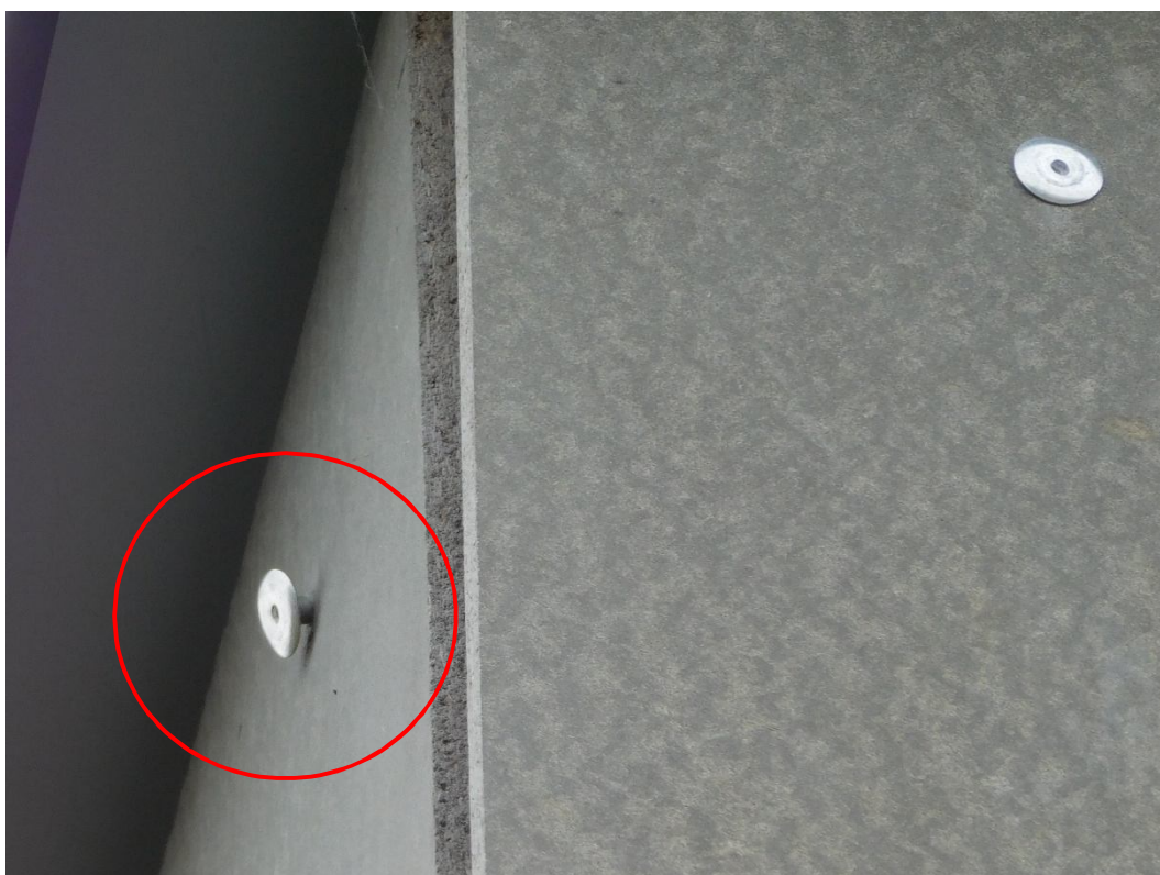
Obr. 47 Odpadávání upevňovacího prvku (nýtu) od nosné podkonstrukce (obklad – cementotřísková deska, nosná podkonstrukce – vodorovné profily, Výzkumné centrum Admas – VUT v Brně, budova P4 – stav ke dni 15. 5. 2016) – špatné použití upevňovacích prvků (nýtů) i nosné podkonstrukce (malý průměr předvrtaných otvorů v desce, krátké nýty, dilatace roštu uprostřed desky apod.)
