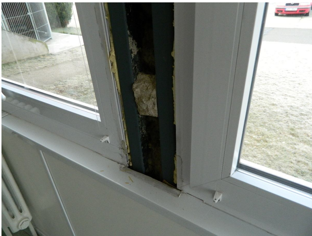
Obr. 54 Chybějící tepelná izolace mezi panely
