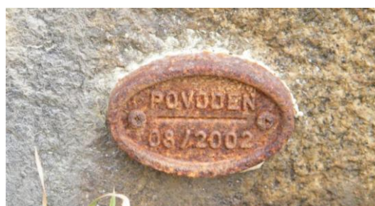
Obr.2 –Detail označení výšky vodní hladiny při povodních v roce 2002
