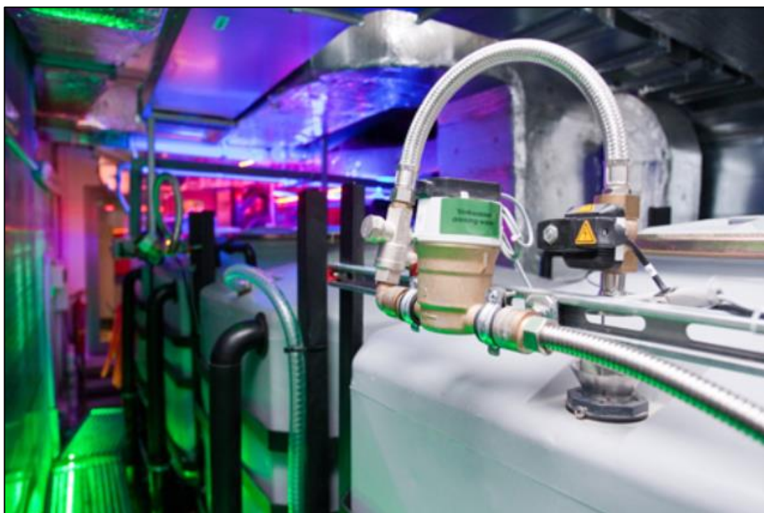
Obrázek 13: Čistírna odpadních vod hotelu Mosaic House (mosaichouse.com, 2020).
