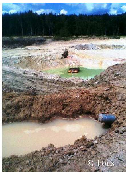
Foto č. 5: Technické zařízení k předčištění a čerpání vody z DP
