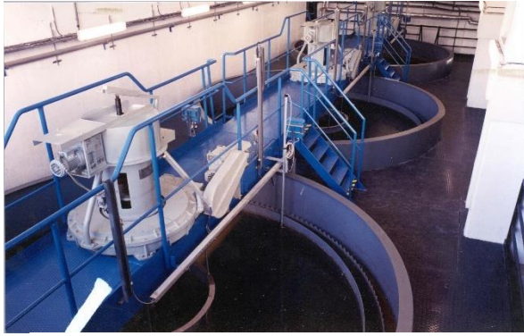
Nádrže kalového hospodářství (foto: Z. Antoš)
