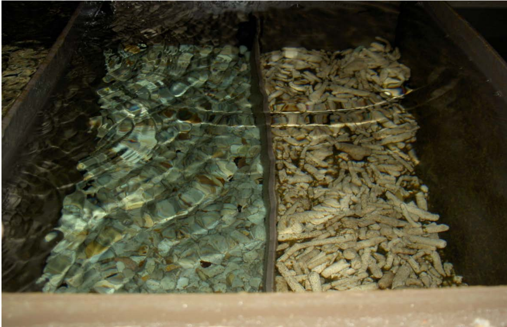
Obrázek č. 21: Filtrační komory se zeolitem a korálovou drtí
