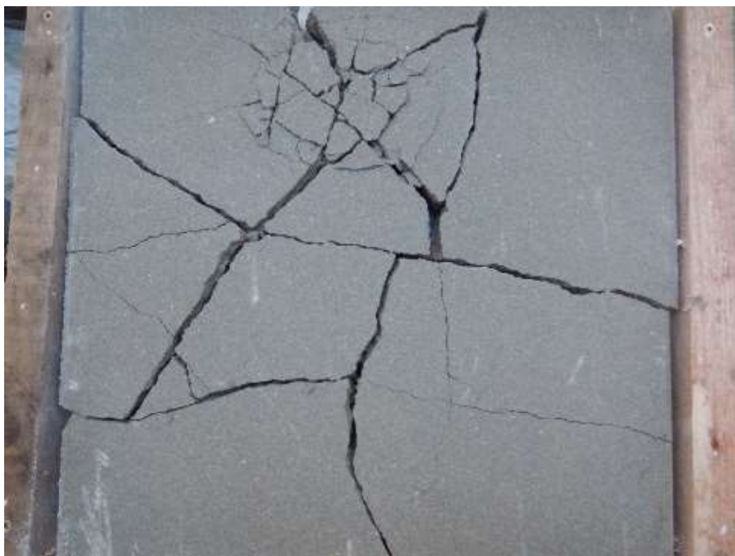
Obrázek 39 Skladba č. 1.3 TBO SG popraskaná betonová dlažba po demontáži vnější vrstvy sádrokartonu Foto: autor
