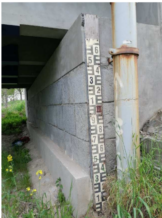
Obrázek 14: Vodočetná lať Uničov.
