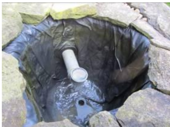
Obrázek č.7 - Prázdný vortex nádrže 1
