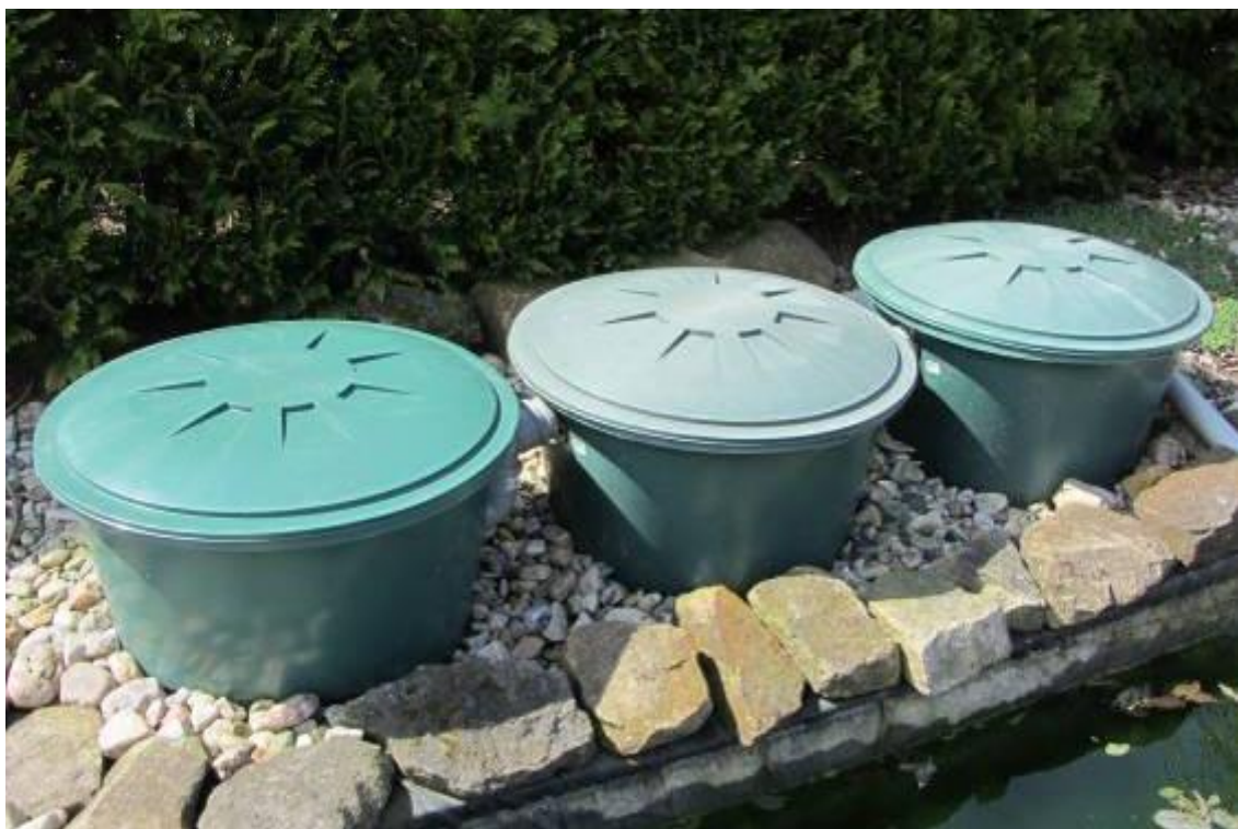
Obrázek č.16 - Komory filtrace nádrže 2
