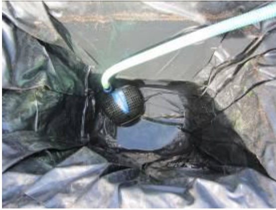
Obrázek č.11 - Čerpadlová šachta nádrže 1
