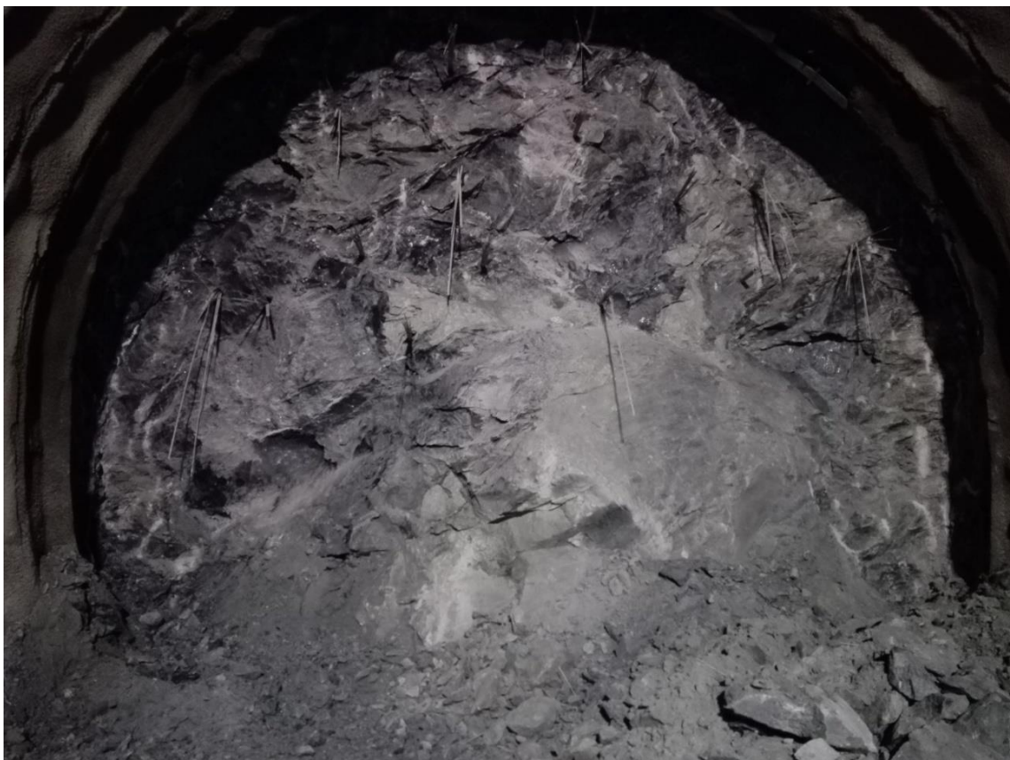
Obr. č. 41 – Dokumentácia čelby STR, B02, st. 22 339, dňa 20.12.2016 Čelba je budovaná čiernastými blastomylonitmi s prechodom do sivých mylonitizovaných granitoidov lokálne s grafitom a povlakom mastenca
