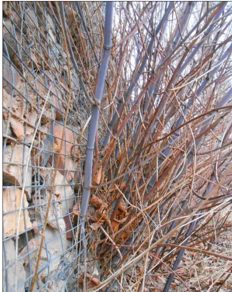
Obrázek 3 – Navážka obsahující oddenky F. japonica byla použita jako inertní odpad při výstavbě gabionu (lokalita Plzeň – Lobzy, prosinec 2018).
