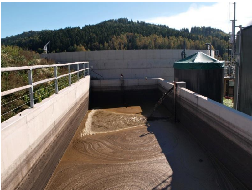
Obr. 1.2 Vstupní jímka otevřeného provedení v BPS v Bělé u Staré Paky [24].
