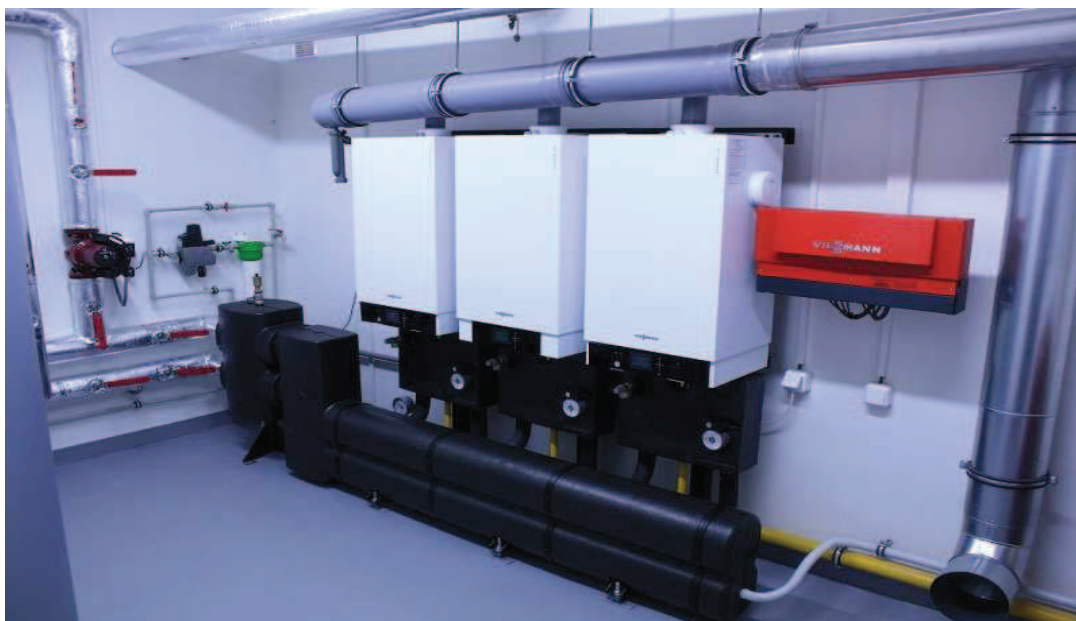
Obr. č. 3 Plynová kondenzační kotelna [4]
