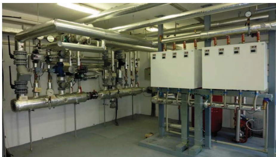
Obr. č. 15 Elektrokotelna[15]
