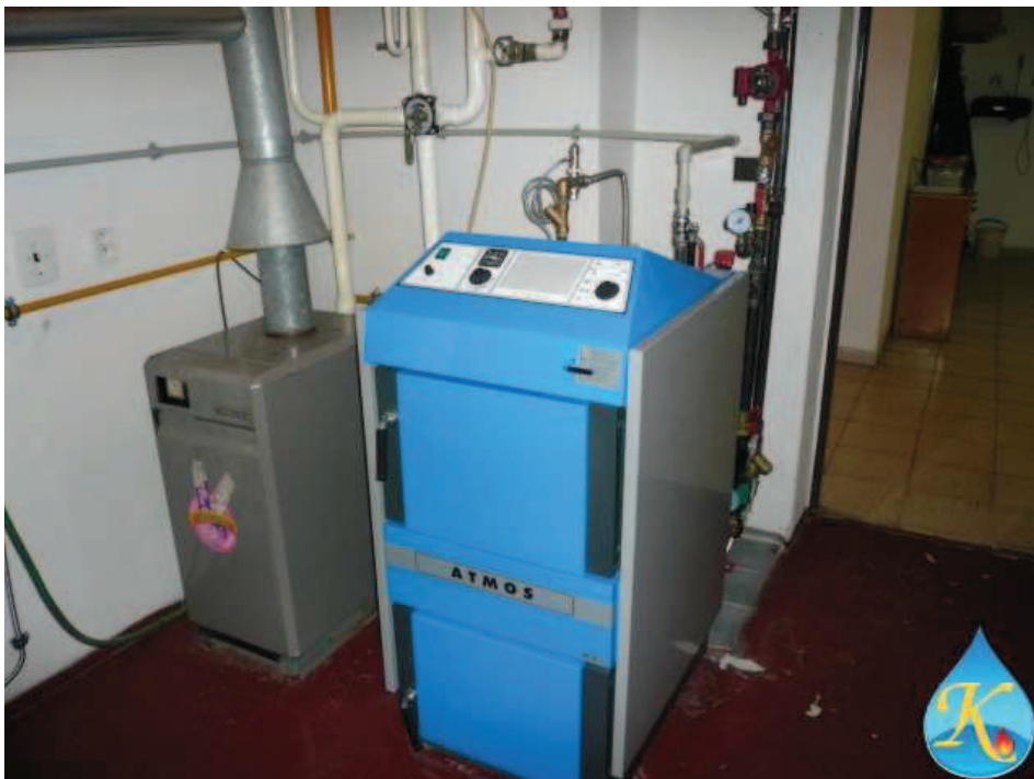
Obr. č. 9.Kotelna na tuhá paliva [10]
