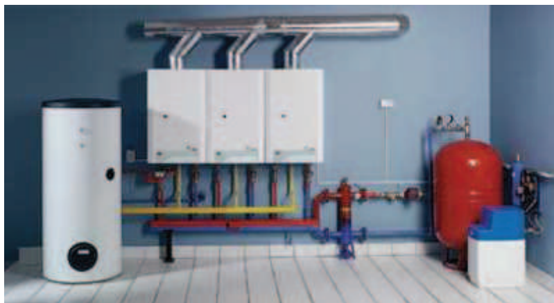
Obr. č.7 Kaskádová kotelna [8]
