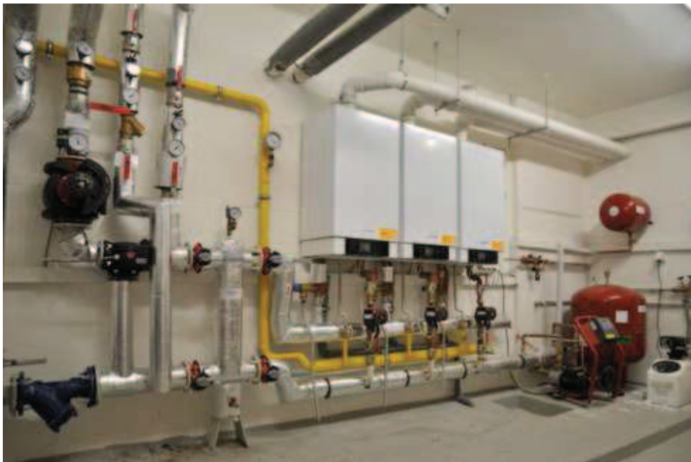
Obr. č. 6 Plynová kotelna [7]
