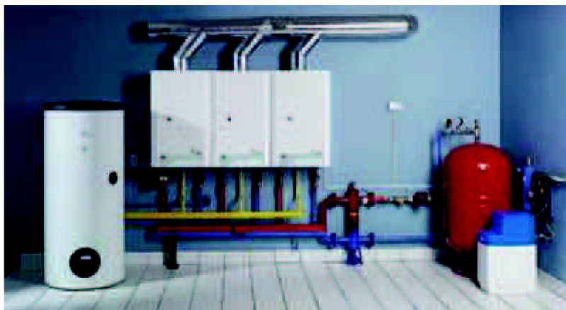
Obr. č.7 Kaskádová kotelna [8]
