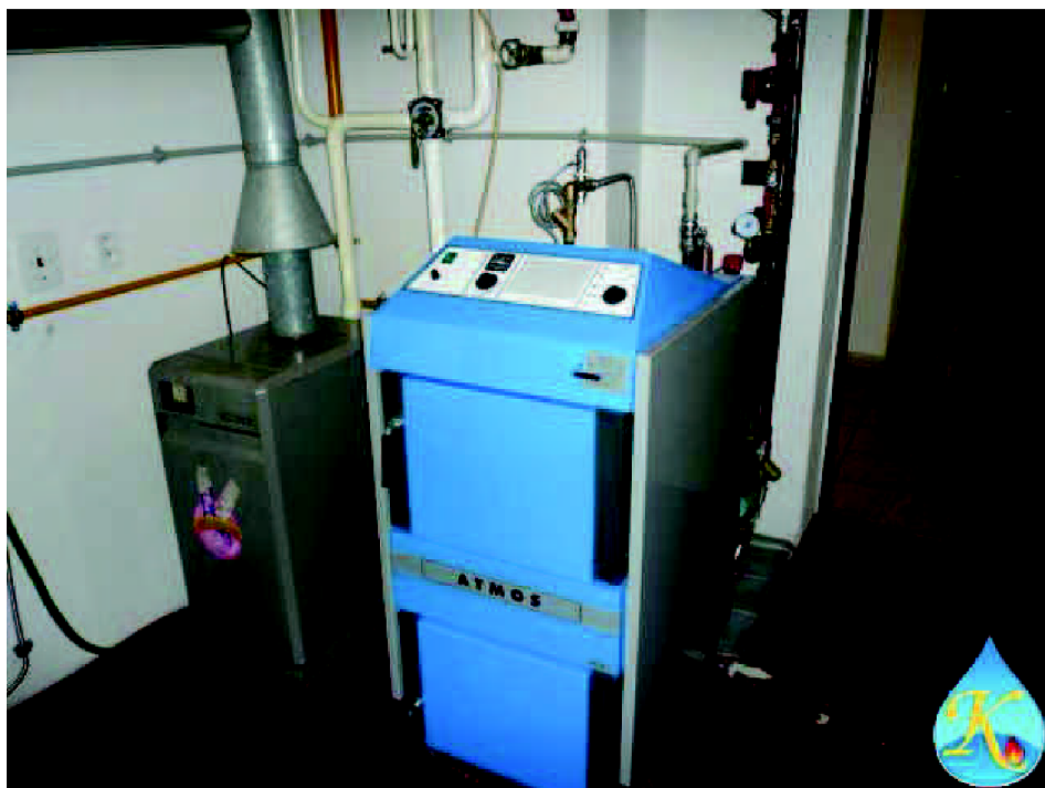
Obr. č. 9.Kotelna na tuhá paliva [10]
