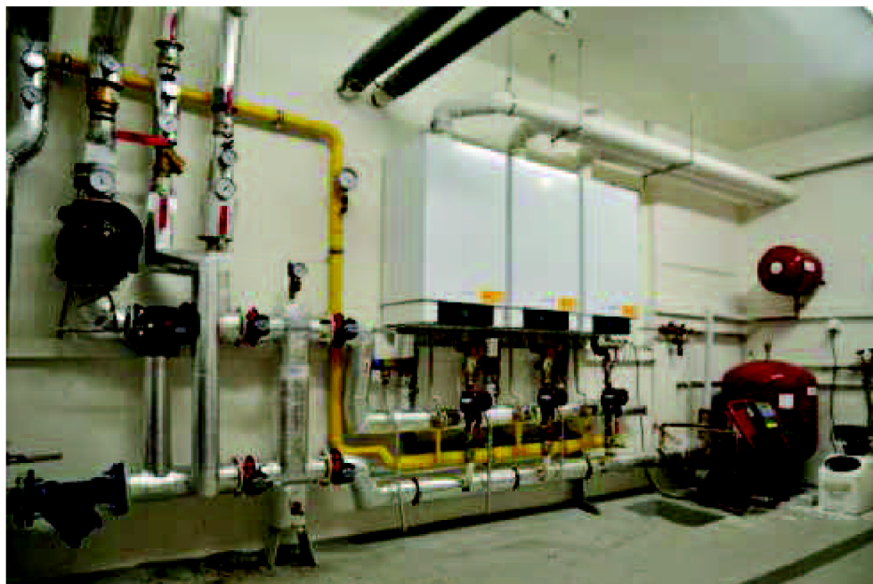
Obr. č. 6 Plynová kotelna [7]
