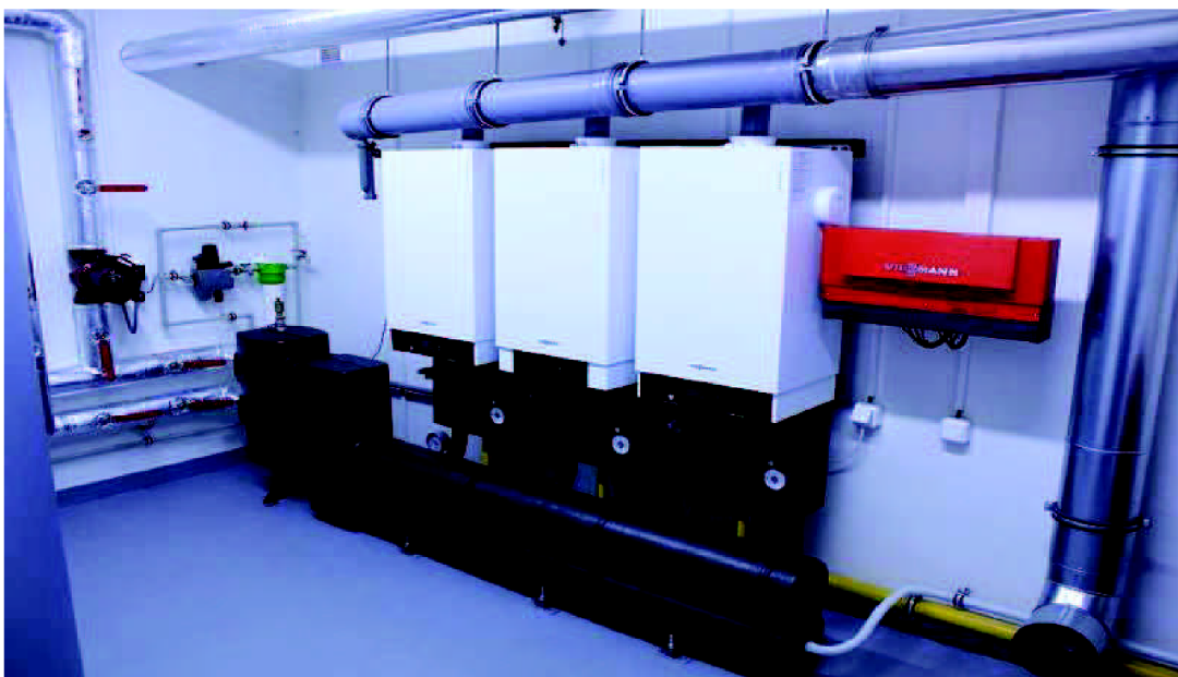
Obr. č. 3 Plynová kondenzační kotelna [4]
