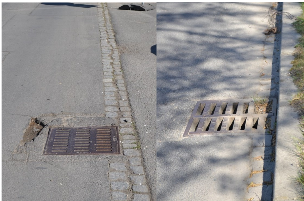
Obr. 3.20 Výmol a nevhodné otočení poklopu na ulici Šumavská
