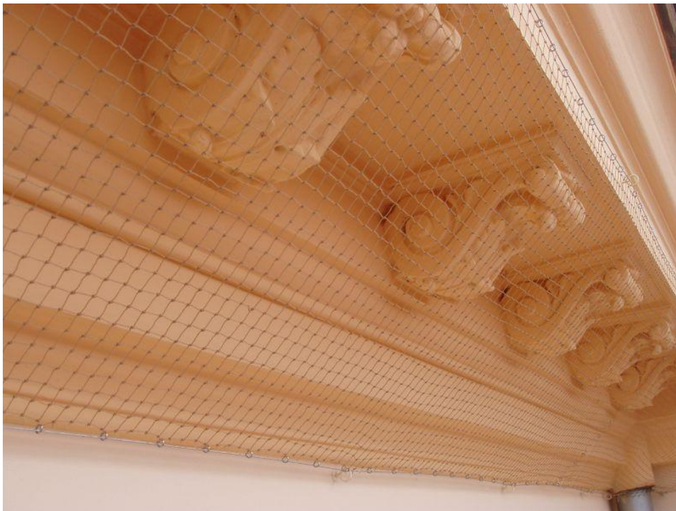
Obr. č. 12.:Ochranné sítě proti vlaštovkám. Zdroj: www.jakes.cz
