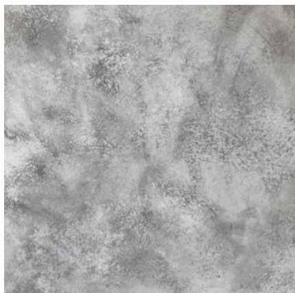
Obrázek 9 - Betonová stěrka detail
