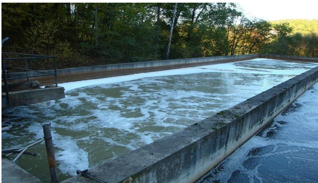
Obr. 4.2 – Akumulační nádrž (zdroj: vlastní foto)
