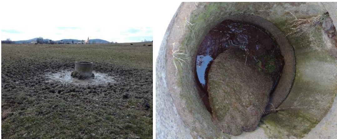
Obrázek č. 13: Nefunkční odvodňovací skruže
