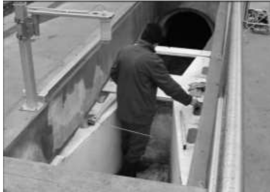
Obr. 9) Ultrazvukový snímač instalovaný před měrným žlabem typu Parshall [4]
