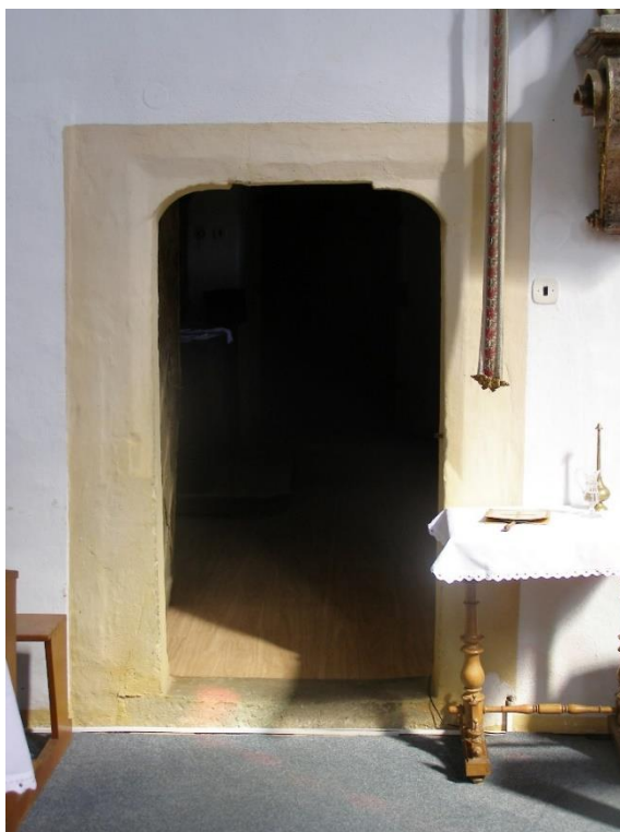
59. obr.: Staré Město pod Sněžníkem, farní kostel sv. Anny, po 1584, ostění vstupu do sakristie.
