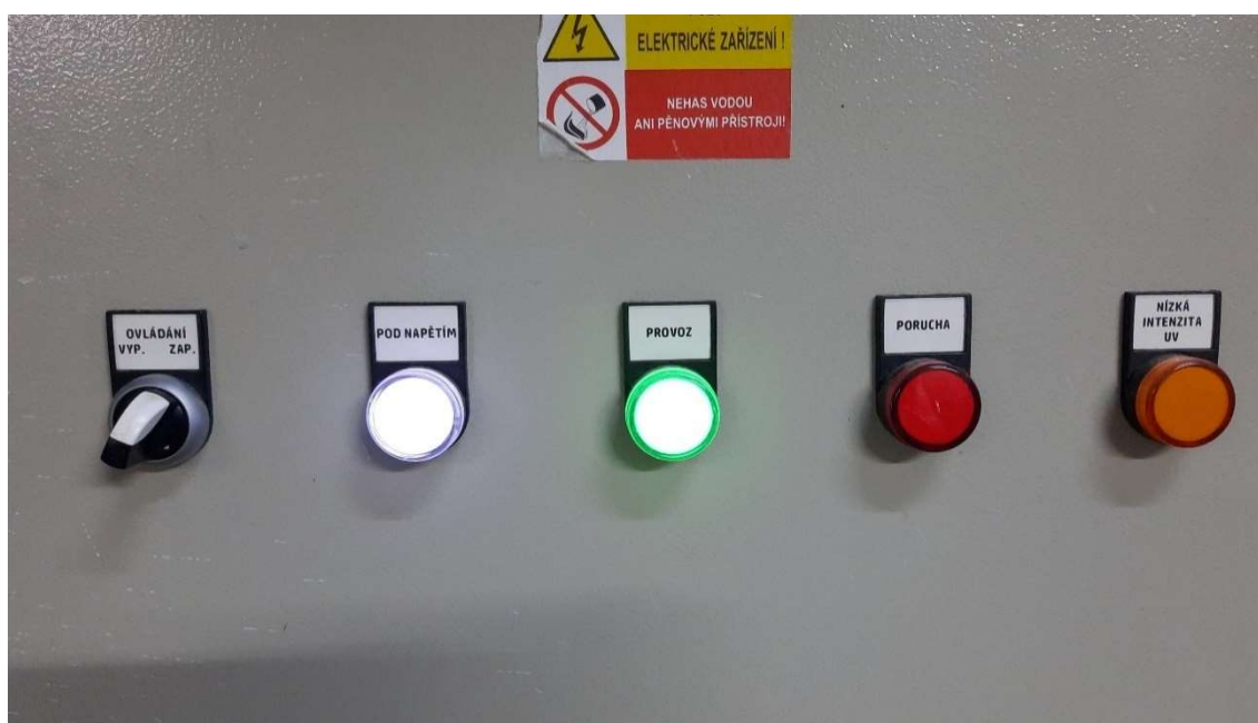
Obr. 27 Kontrolní jednotka UV lamp
