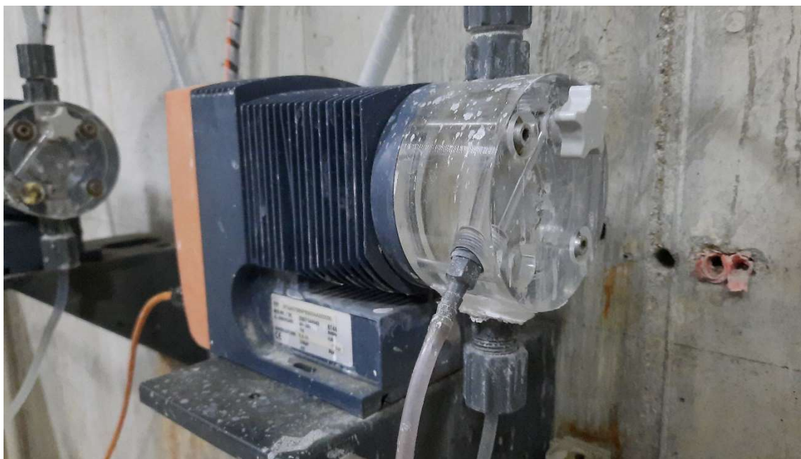
Obr. 22 Membránové dávkovací čerpadlo chlornanu sodného, detail
