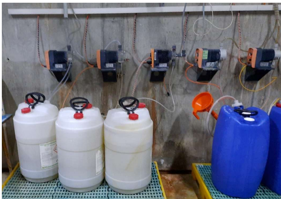
Obr. 21 Dávkování chlornanu sodného
