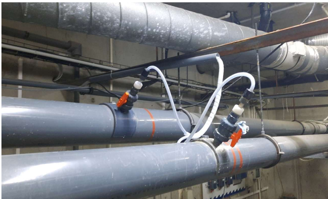
Obr. 28 Dávkování chlornanu sodného, recirkulační okruh plavecký bazén
