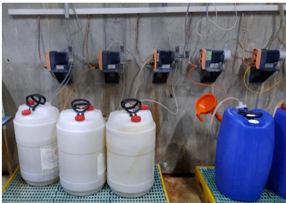
Obr. 21 Dávkování chlornanu sodného
