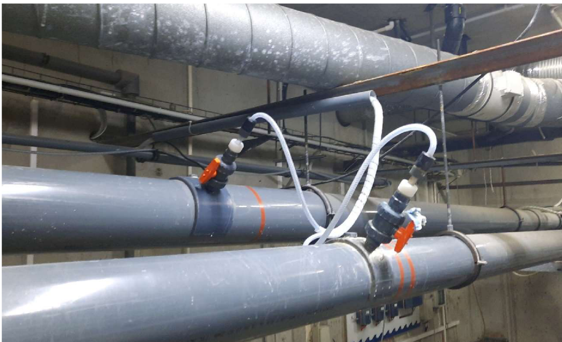
Obr. 28 Dávkování chlornanu sodného, recirkulační okruh plavecký bazén
