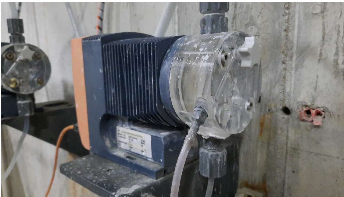
Obr. 22 Membránové dávkovací čerpadlo chlornanu sodného, detail
