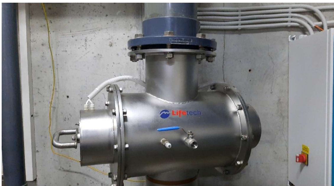
Obr. 24 Systém LifeOX® typu UVM, UV lampa, recirkulační okruh plavecký bazén
