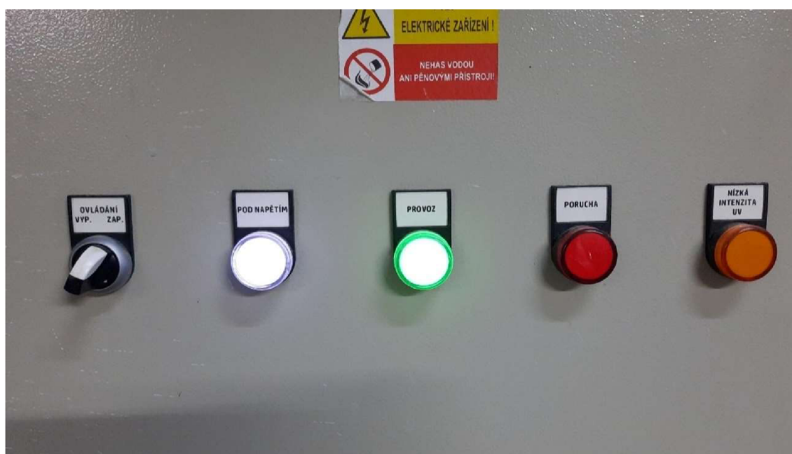
Obr. 27 Kontrolní jednotka UV lamp
