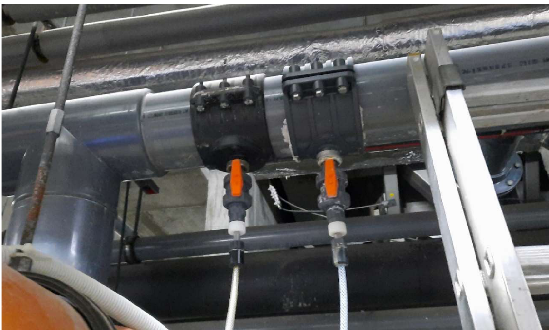
Obr. 23 Dávkování chlornanu sodného do potrubí, recirkulační okruh vířivka
