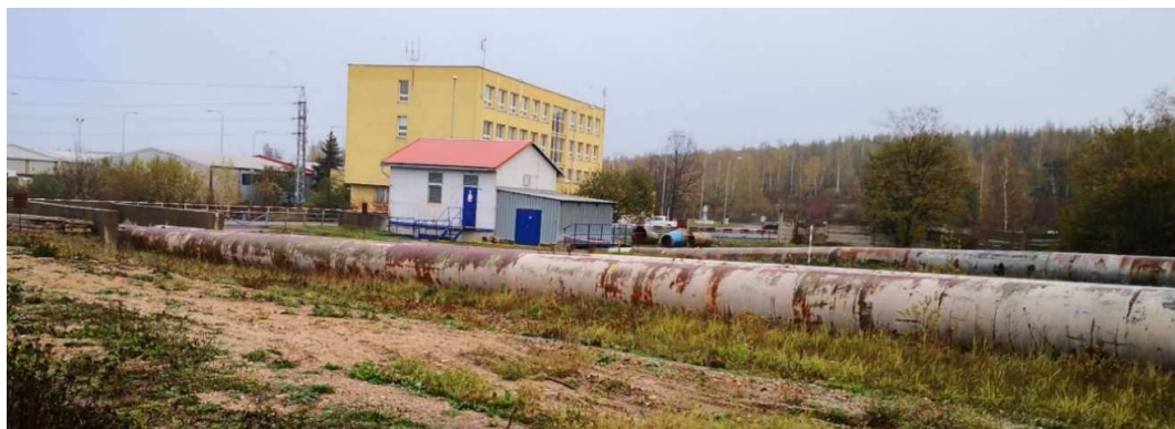
Obr.15 MVE a trubní vedení Ervěnický koridor
