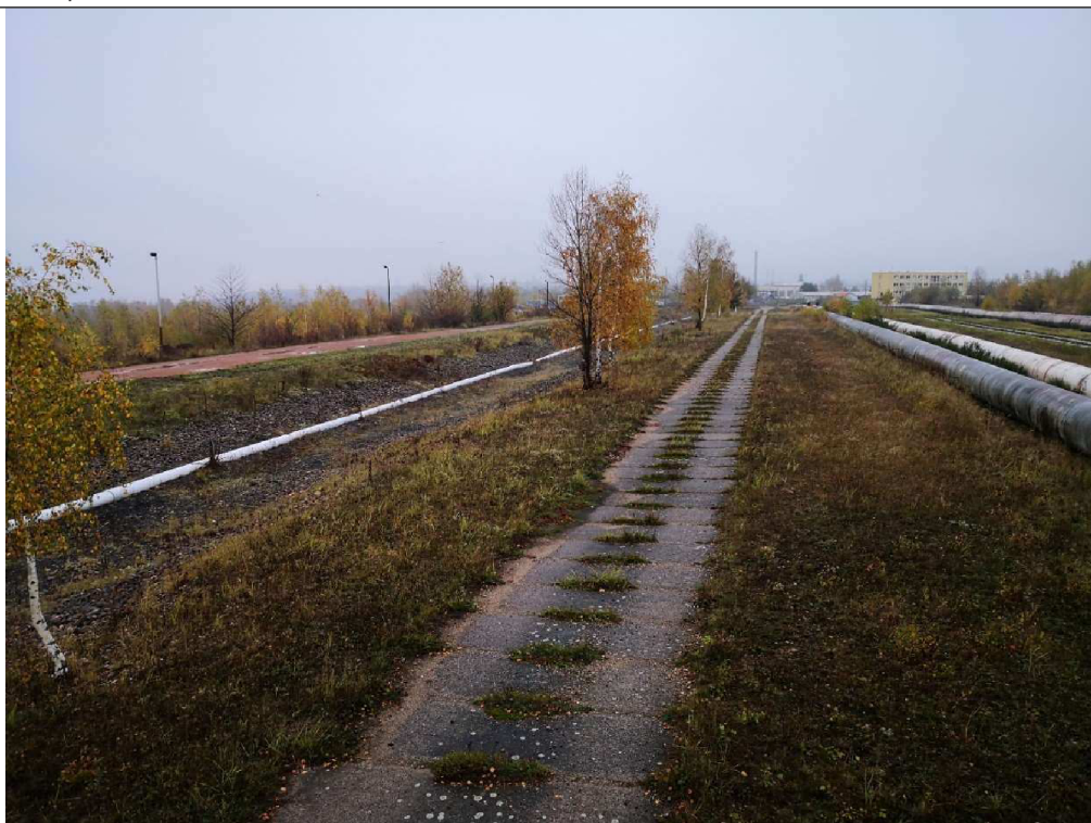
Obr.14 Nouzové koryto a potrubní vedení EK
