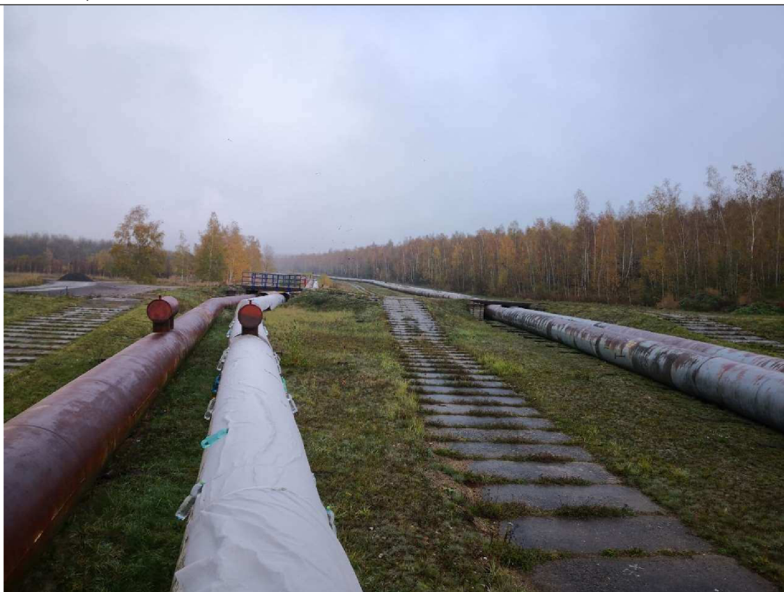
Obr.37 Obtokové a přívodní potrubí na MVE Ervěnický koridor
