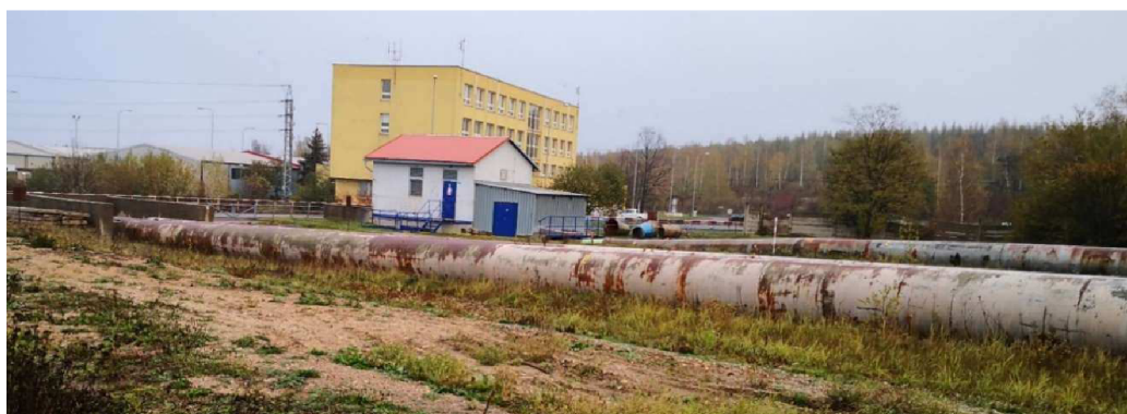
Obr.15 MVE a trubní vedení Ervěnický koridor
