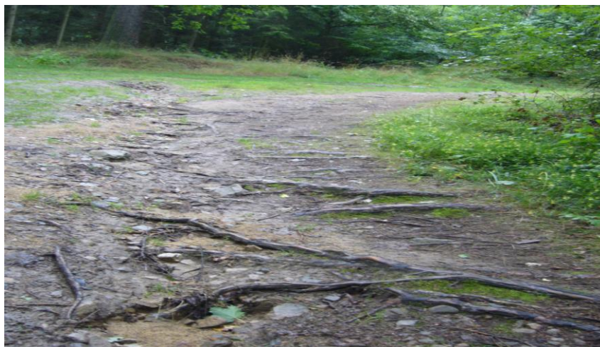
Obr. 6 Eroze turistické stezky
