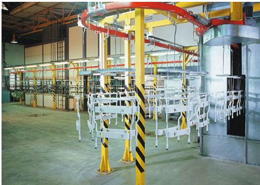
Obr. 4.: Podvěsný dopravník přepravující lakované díly
