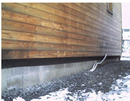
Obr 32 Snímek nezatepleného soklu
