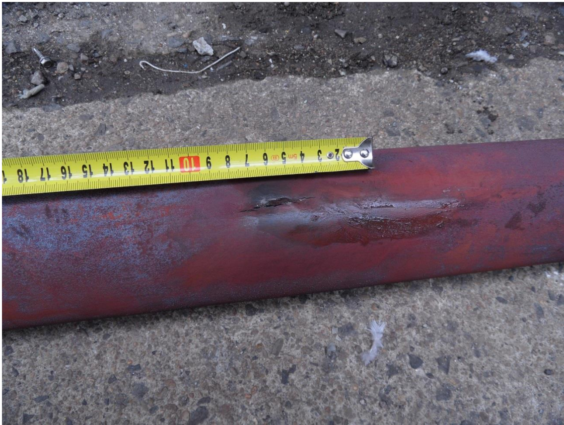
Obr. 2.2 – Pohled na trubku s trhlinou
